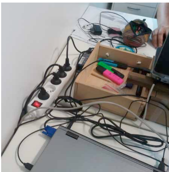
Une multiprise visible et accessible
