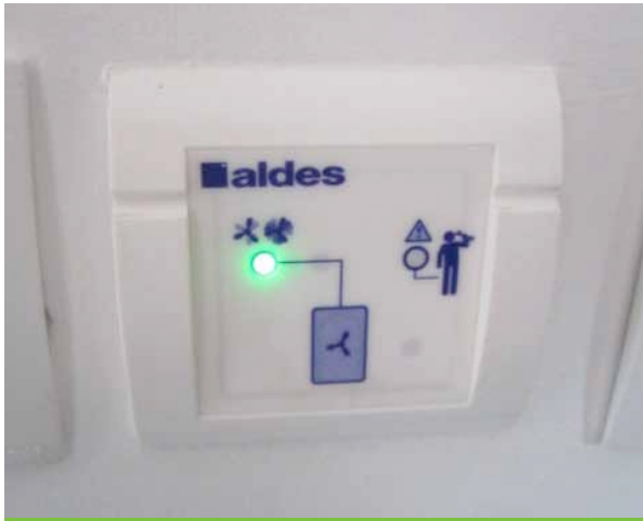
L'interrupteur de surventilation dans la cuisine
