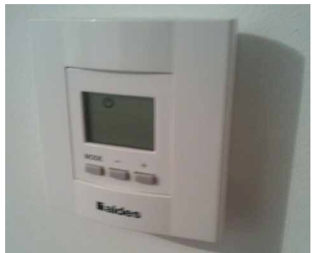
Un thermostat dans chaque pièce au Patio
