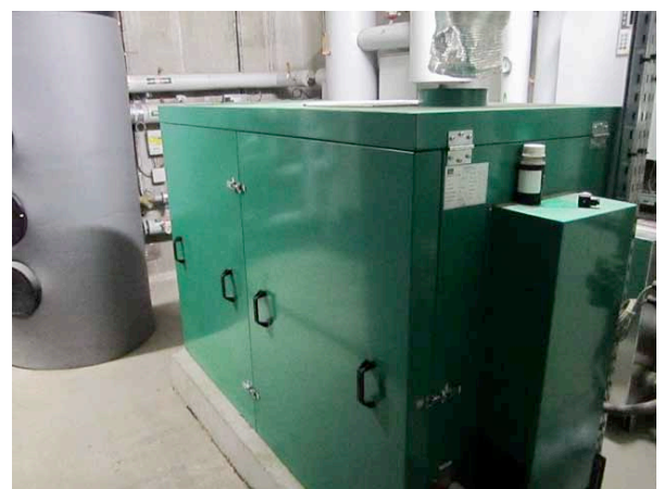
La cogénération dans la sous-station du Patio
